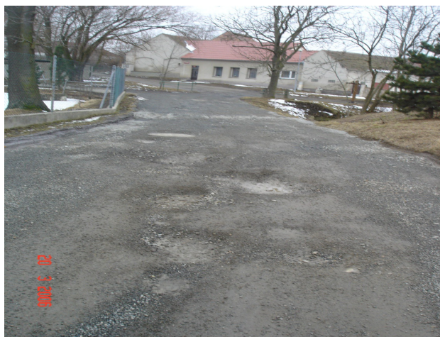
Foto : z provizorních oprav po několika týdnech
